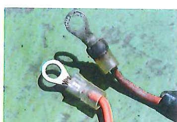
写真はR用ではないが、左が正常で、右が接触不良を起こし、焼けた配線とカシメ。これは最悪な状況だが、負担がかかっている部分は数多くある
